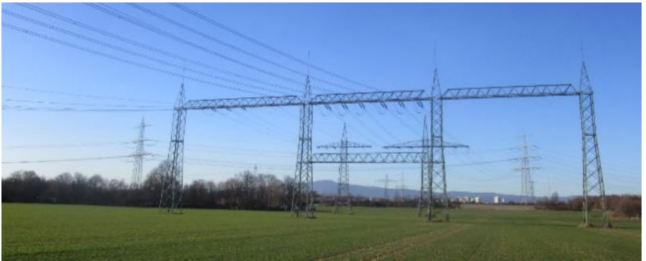
Abb. 4: Portalmasten am Umspannwerk West (Blick nach Nordwesten)
