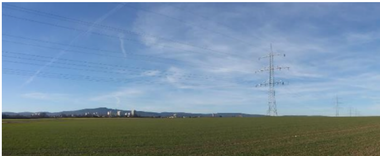
Abb. 6: 110-kV-Freileitung der Syna, die von Amprion mit zwei 380-kV-Systemen aufgerüstet werden soll
