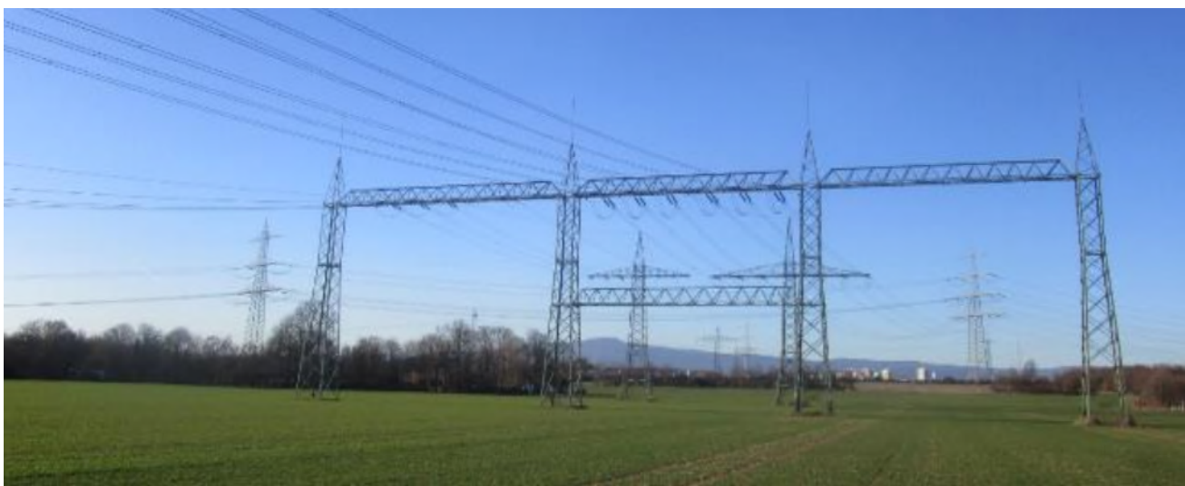
Abb. 4: Portalmasten am Umspannwerk West (Blick nach Nordwesten)
