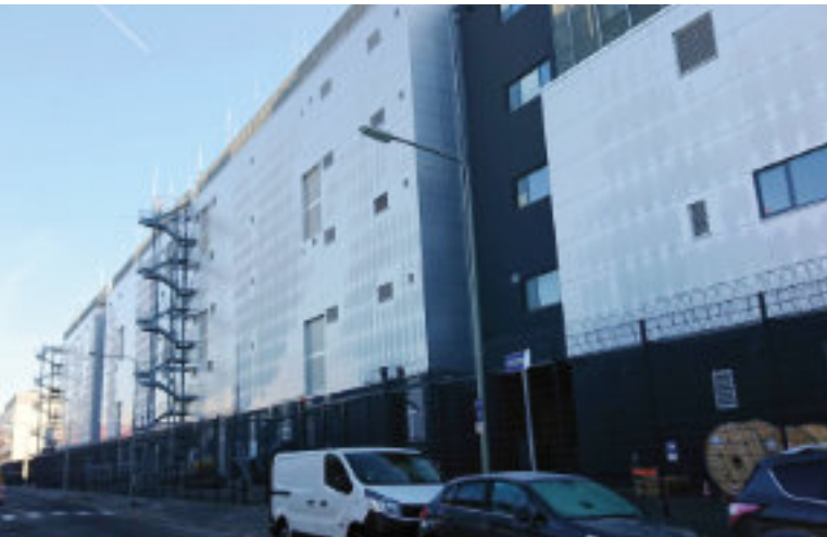
Rechenzentren in der Weismüllerstraße
