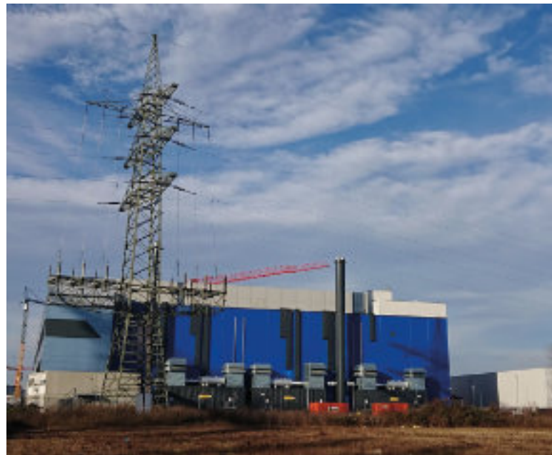
Eine gute Stromversorgung wie hier in Sossenheim ist ein wichtiger Standortfaktor
